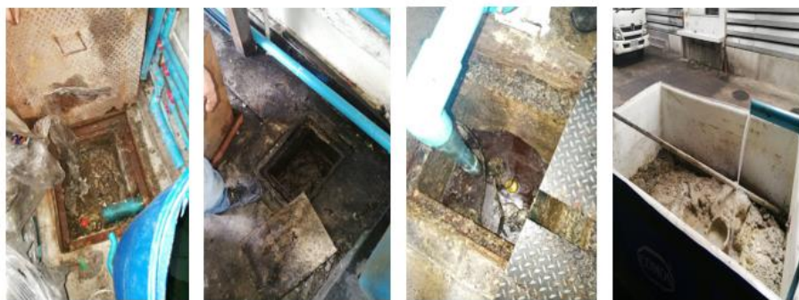
ภาพที่ ๔.๕ : สิ่งปฏิกูลที่อุดตันใส่ท่อ และบ่อพักน้ำเสีย ๑๕๐
