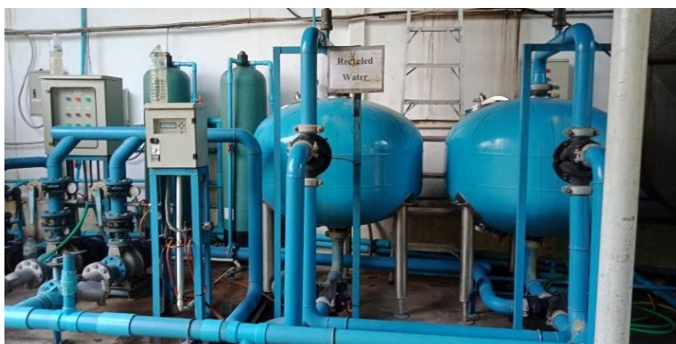
ภาพที่ ๑๘ : ระบบนำน้ำที่บำบัดแล้วกลับมาใช้ใหม่ภายในโรงงานเถาแก่น้อย ๑๖๔
